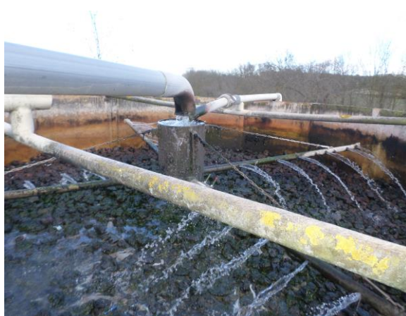
Alimentation depuis le décanteur-digesteur
