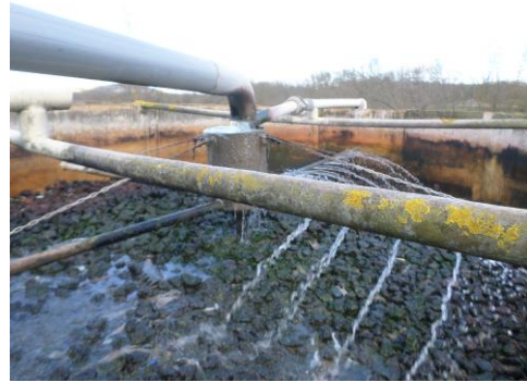
Alimentation depuis le décanteur-digesteur
