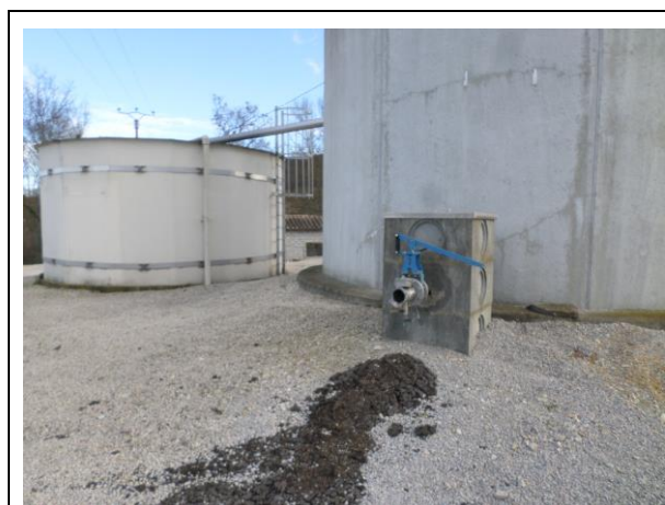
Conduite des boues pour l'épandage
