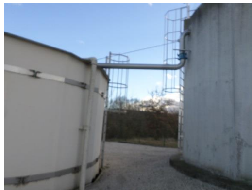
Arrivée de la conduite du décanteur-digesteur dans le lit bactérien
