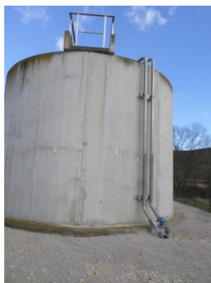
Alimentation par les conduites de refoulement + recirculation des boues et des eaux claires depuis le clarificateur
