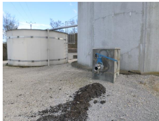
Conduite de sortie des boues
