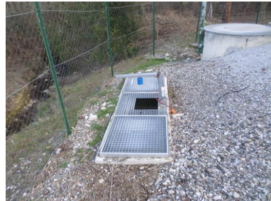
Canal débitmétrique entre le clarificateur et le rejet
