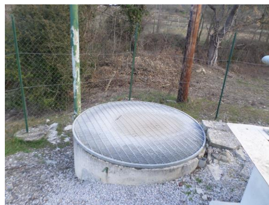
Ouvrage de recirculation des boues
