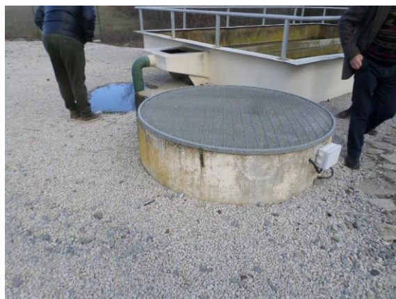
Ouvrage de recirculation des eaux claires
