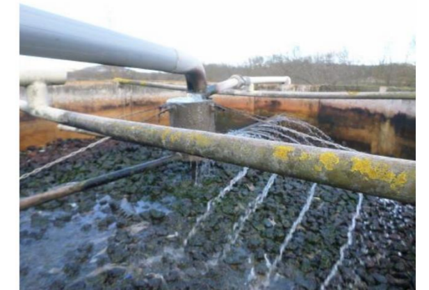
Alimentation depuis le décanteur-digesteur
