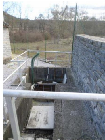
Poste de relevage
