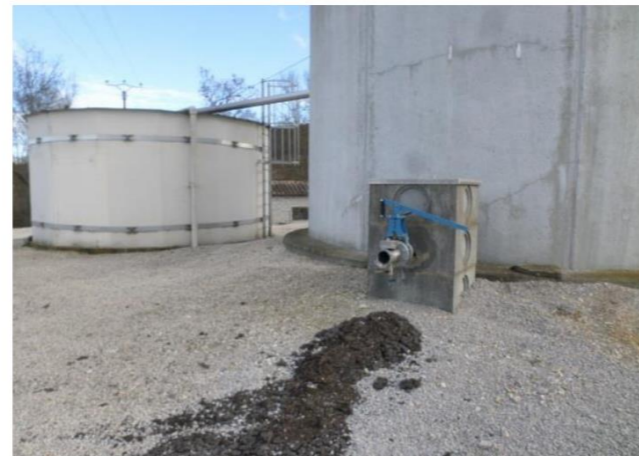
Conduite de sortie des boues
