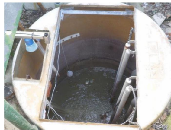
Poste de relevage
